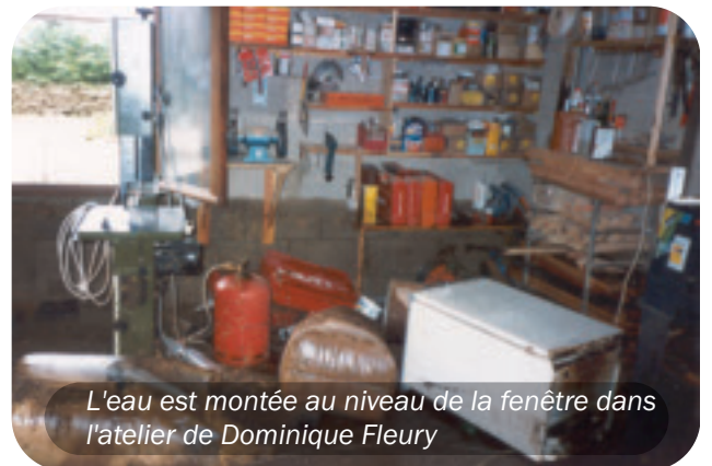
Après le nettoyage de la boue, les traces subsistent sur les murs et les meubles
