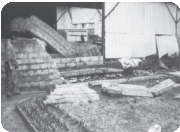
Le mur du hangar de Jean-Paul Dumontel a été emporté par l'eau
